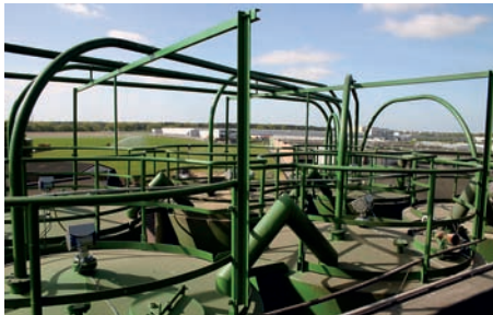
OPTIFLEX 1300 auf den Silos. Die Seilsonden laufen durch das gesamte Silo und sind am Boden befestigt
