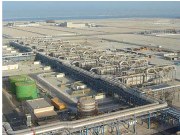
Usine de dessalement SIDEM à Marafiq – Arabie Saoudite
